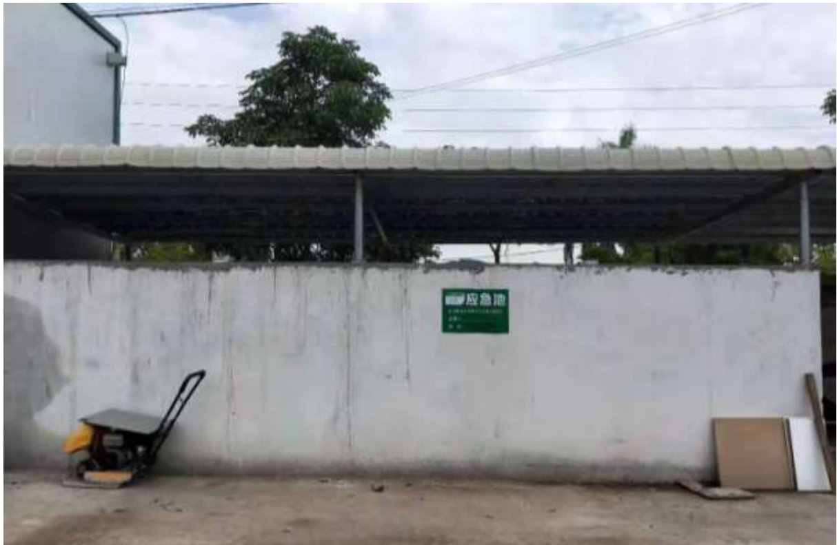
附图 10 事故应急池照片
